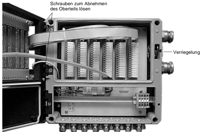
Bild 1-1: Blick in den geöffneten Anschlußraum
